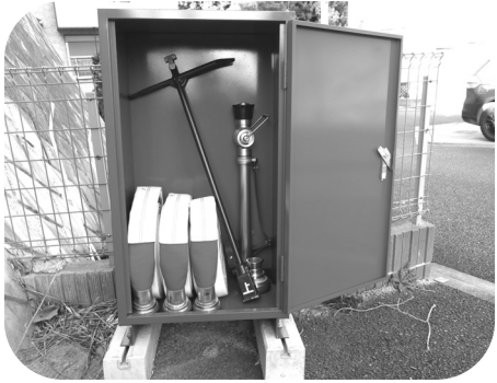
八幡神社後方入口に新設された消火箱
